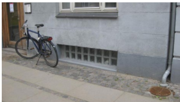
Kjellervinduer er erstattet med glassten. Foto: Rørcenteranvisning 020.
