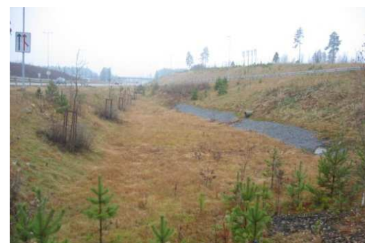
Infiltrasjonsløsning for håndtering av overvann fra vei. Innløp til høyre i bildet. Overløpskum koblet til underjordisk pukkmagasin til høyre som treer i funksjon ved ekstraordinær tilrenning eller tele i bakken (E16 Gardermoen, Jessheim).
