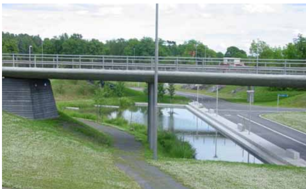
Vått basseng for overvann fra veianlegg som kombinerer rensing, fordrøyning og god landskapstilpasning (Fornebu)
