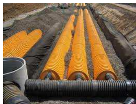
Eksempel på fordrøyning i halvt rørmagasin kombinert med infiltrasjon.
