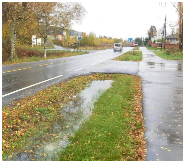
Figur 24: Manglende eller tett stikkrenne på Vittenberg, Lørenskog (Foto: Yvona Holbein)
