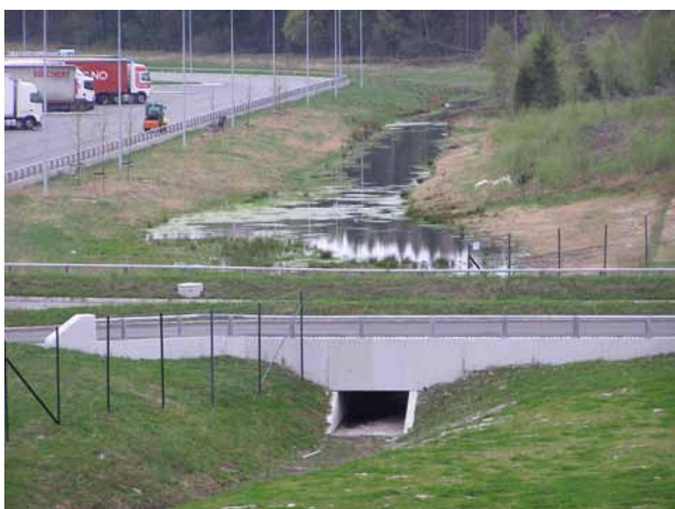
Figur 5. Et større åpent fordrøyningsmagasin er anlagt i et tidligere bekkedeie på tomtens laveste punkt. 75 cm skiller laveste og høyeste vannstand. Slake vegetasjonsdekkede skråninger sikrer god infiltrasjon og sedimentasjon av overflatevann fra parkeringsarealer. Foto: Eivind Saxhaug
